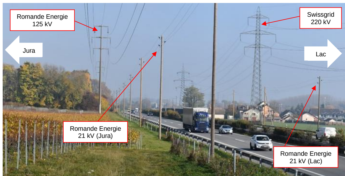
Figure 1 : Photo des 4 lignes électriques – Source : Groupement NIP, prise de vue 11.11.2021
