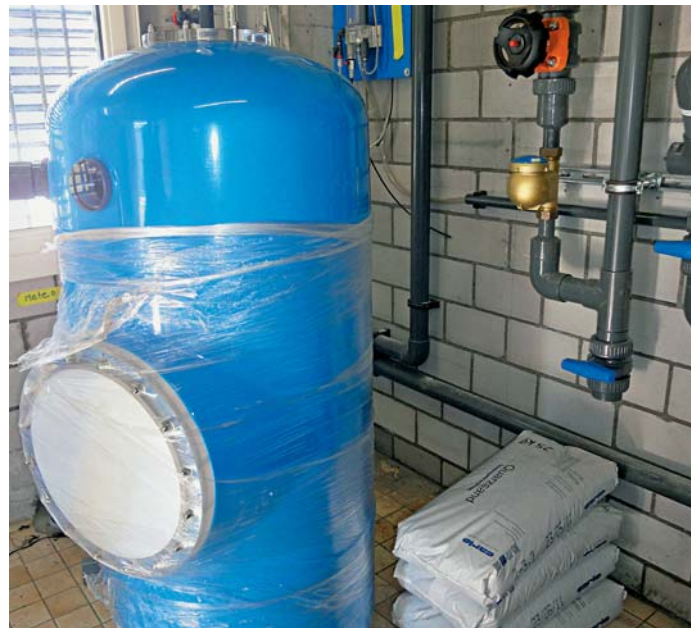
Die neue Badwasserneutralisationsanlage.
