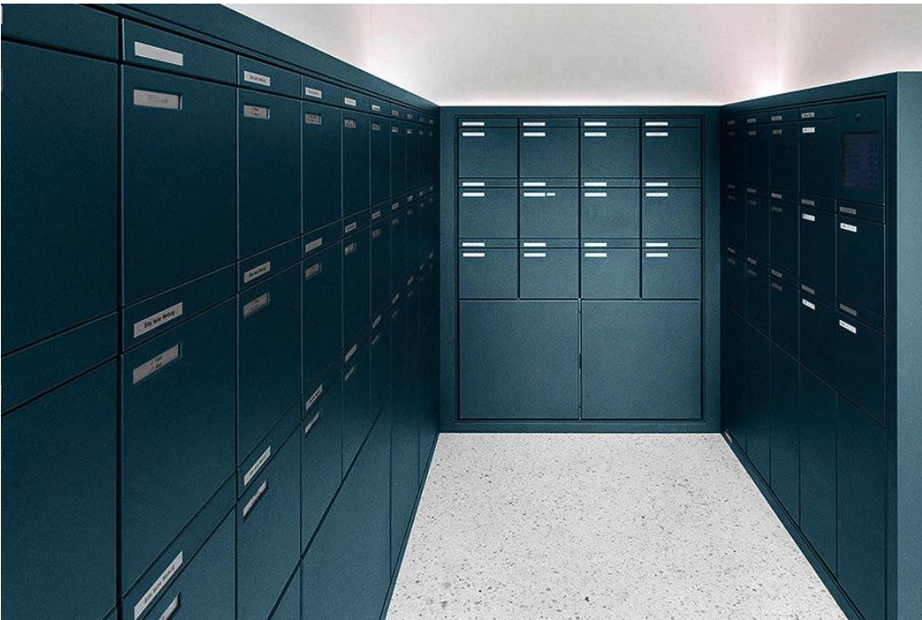
Référence: Osterwalder Tower (installation construite par Schweizer)
