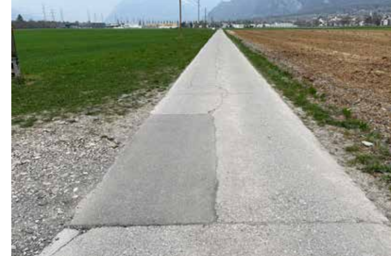
Schäden an der Betonspur
