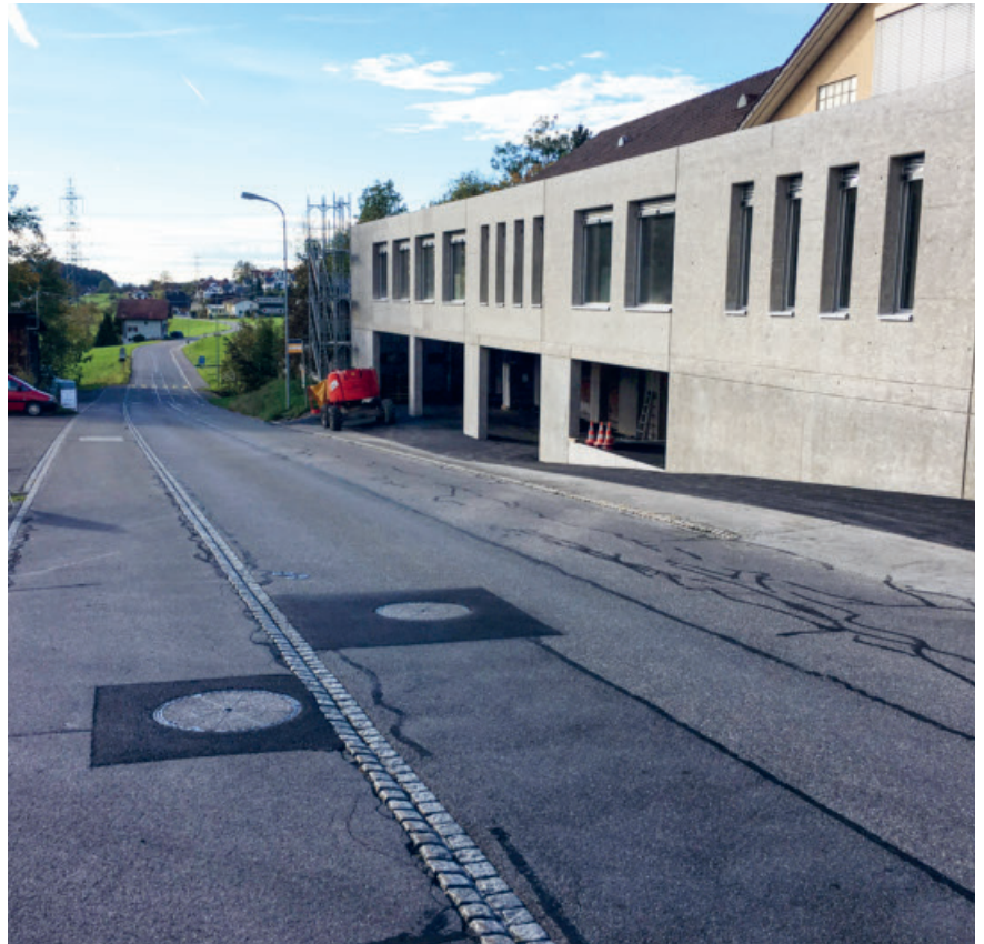
■ Sanierungsbedürftige Ernetschwilerstrasse mit Bushaltestelle «Kistler».
