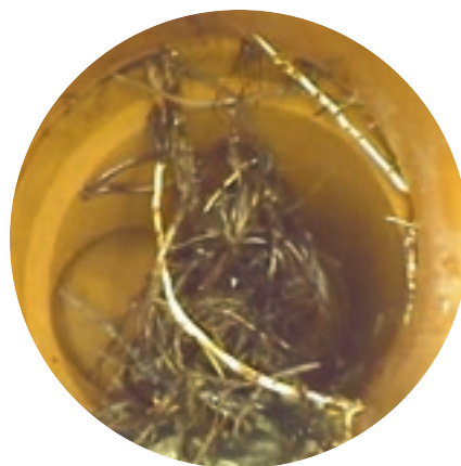
Wurzeleinwuchs bei Wasserleitung
