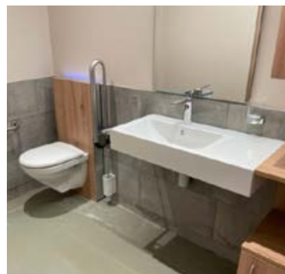
Nasszellen, WC mit Ergo-Griffen ausgerüstet.
