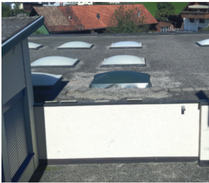
wie über dem Geräteraum muss dringend saniert werden. Die Wärmeisolierung ist ungenügend und entspricht nicht länger den Standards, die Uznach als Energiestadt anstrebt. Etliche Oblichtkuppeln sind undicht, unterhaltsintensiv und kaum noch zu reparieren, weshalb ein Teil bereits abgedeckt werden müssen. Der Lichteinfall ist meistens ungenügend, weshalb die Hallenbeleuchtung trotz Oblichtern eingeschaltet werden muss. Der gesamte Dachaufbau über der Turnhalle wird bis auf die Tragkonstruktion aus Metall entfernt. Danach werden eine Dampfsperre, eine verbesserte Wärmedämmung, eine Flach-
