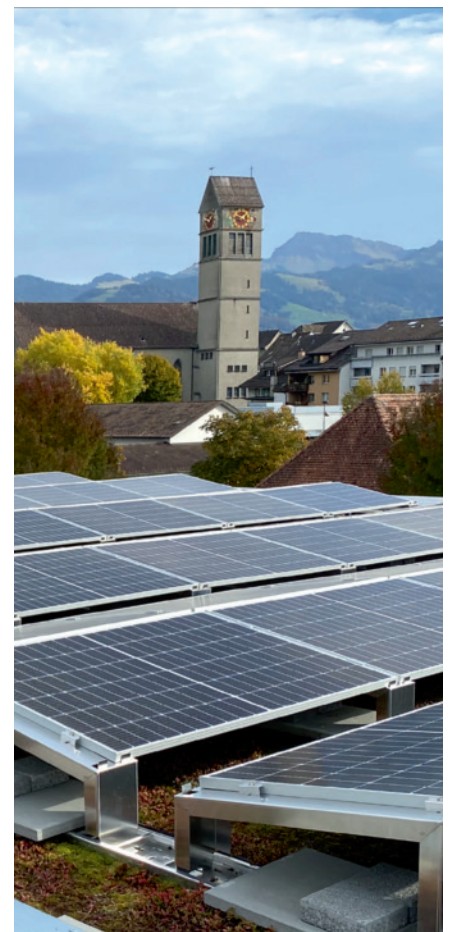
Neu erstellte Photovoltaikanlage auf dem Oberstufenschulhaus Haslen
