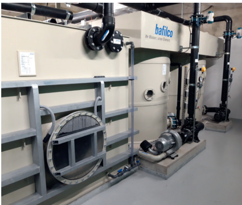
Neue Schwimmbadwasseraufbereitungsanlage mit Wärmerückgewinnung
