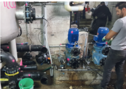
Alter Wasserfilter kurz vor dem Ausfall
