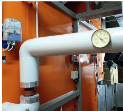
Lüftungsgerät für Schwimmbad (ohne Wärmerückgewinnung)
