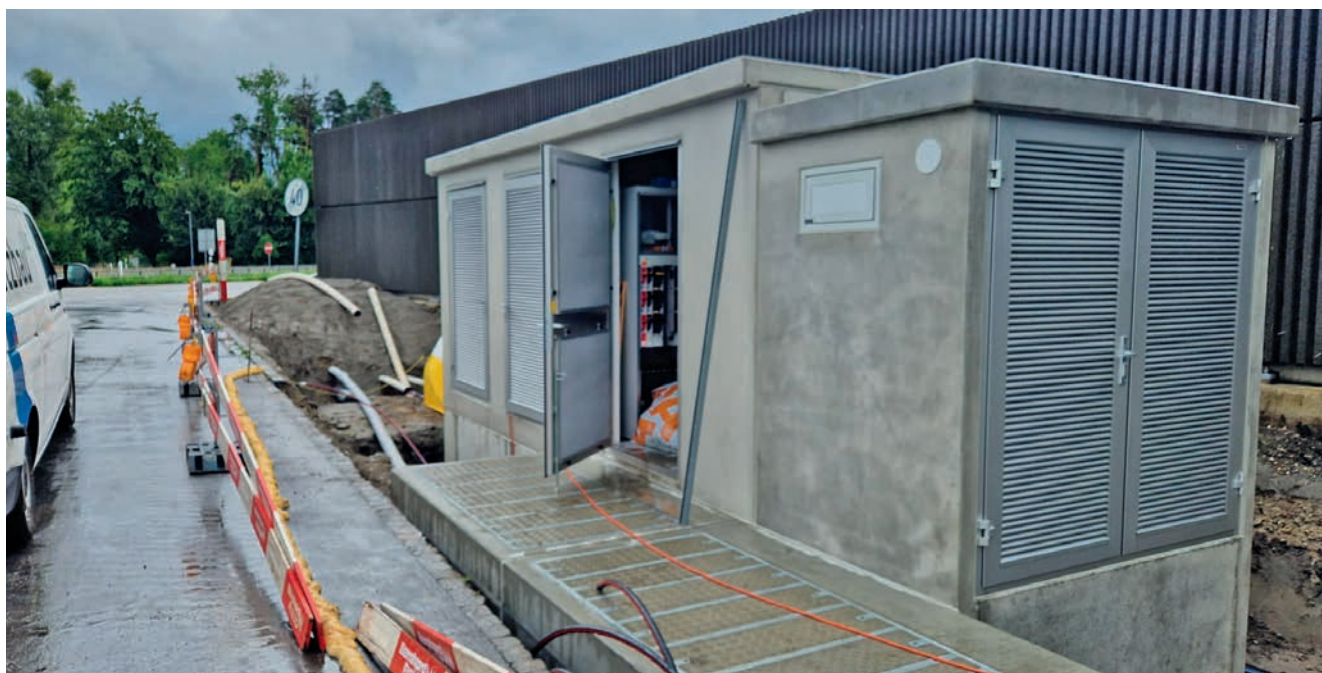
TS Avia Raststätte für E-Ladestationen.
