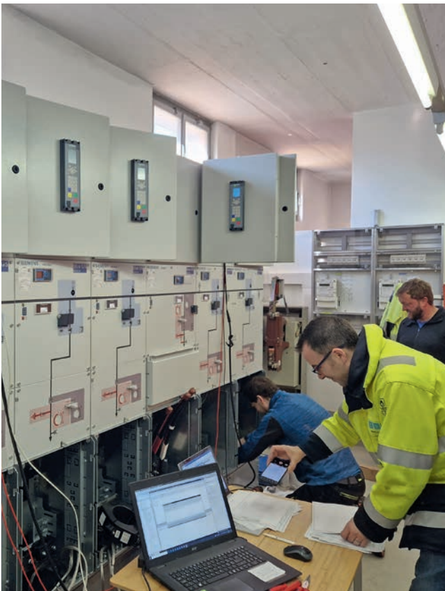
EW Ersatz Mittelspannungsschalt-Anlage TS Bauwerk.
