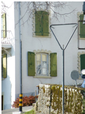
Photo 1 : Fissuration bâtiment sur la niche du GPP nord
