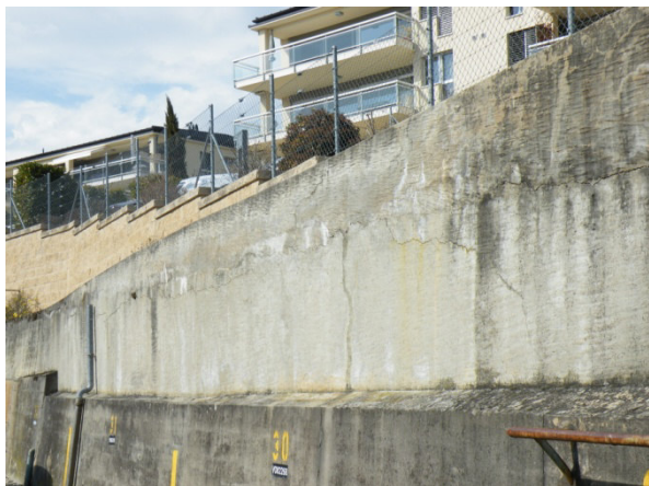
Photo 5 : Mur de soutènement en limite nord du plan de quartier, fissuration par poussée des terres
