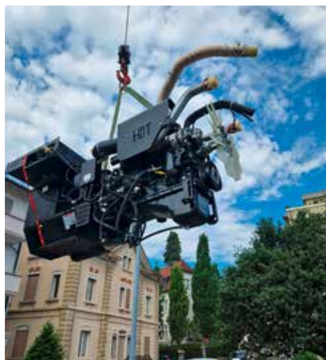
Neuer Notstromgenerator «Drei König».
