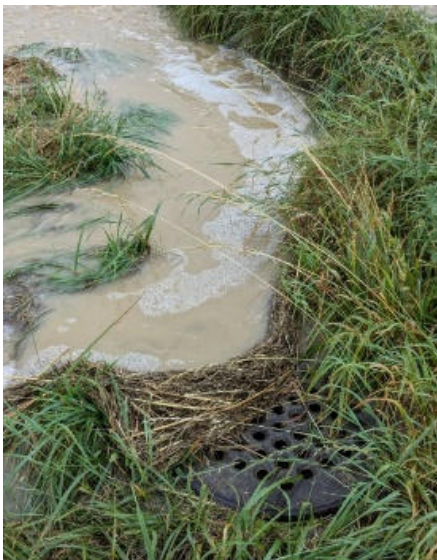
Abbildung 32: Einlaufrost während Hochwasserereignis mit Geschwemmsel verlegt
