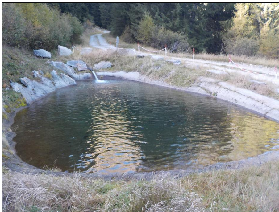
Figura 1: Il bacino antincendio costruito in zona Pianca non adempie più alle esigenze attuali.
