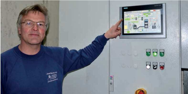
Steuerungsschrank mit Touchscreen, wo man sämtliche Anlagedaten und natürlich am interessantesten, die Stromleistung ablesen kann.
