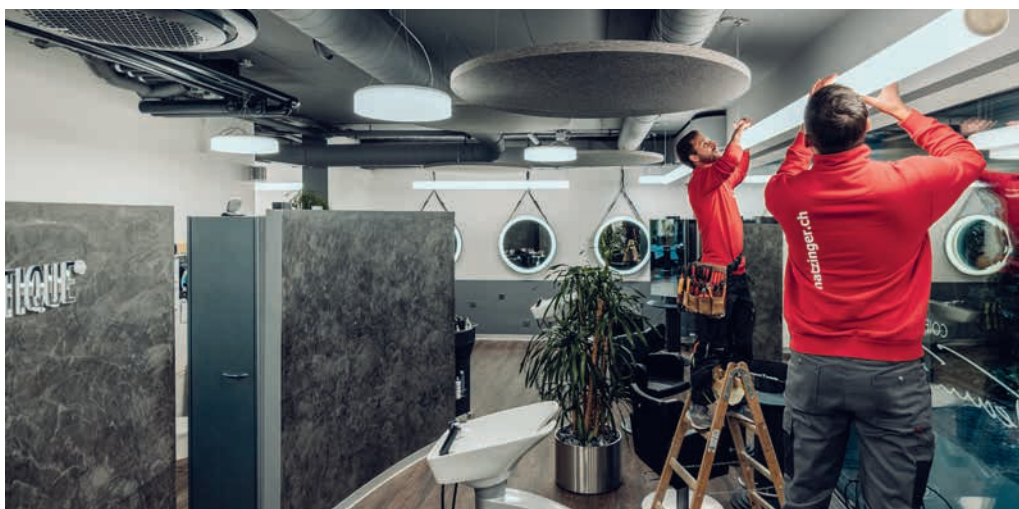
Beleuchtung und Elektroinstallationen bei Coiffeur Team Freihofer in Winterthur.
