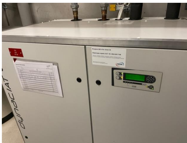
Image 9 : Baraka – chauffage, refroidissement – pompe à chaleur
