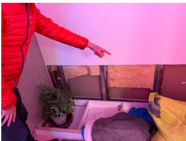
Image 11 : Baraka - problème d'infiltration d'eau – réparation en cours
