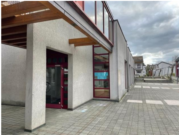
Image 4 : Bâtiments scolaires – les façades sont à refaire
