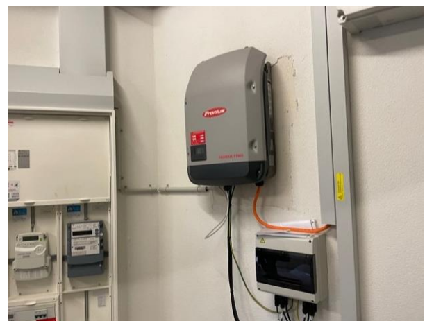
Image 7 : Baraka - Salle de récupération des eaux de pluie - onduleur pour panneaux photovoltaïques
