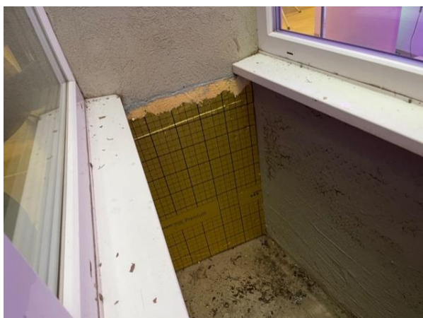
Image 12 : Baraka – l'infiltration d'eau – saut-de-loup problématique
