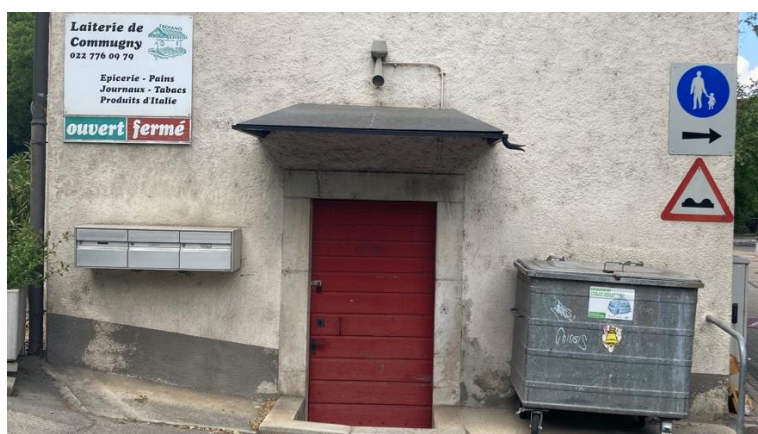
Image 1 : Laiterie - Façades à refaire mais dans le cadre d'une rénovation de l'extérieur du bâtiment
