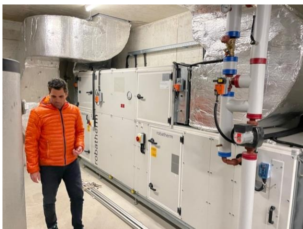
Image 8 : Baraka - chauffage, refroidissement - machine de refroidissement.
