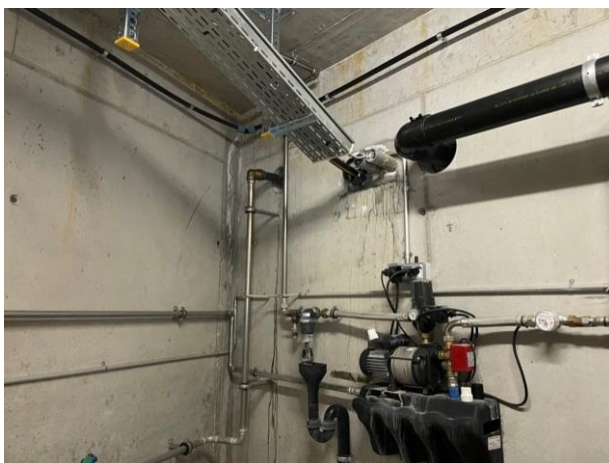
Image 6 : Baraka - Salle de récupération des eaux de pluie - tuyau avec fuite d'eau bouché
