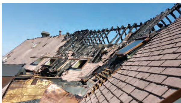
Vue partielle de la toiture de l'immeuble « La Prairie » après le sinistre
