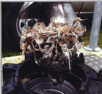
Verstopfte Pumpen, aufwändige Instandstellung.
