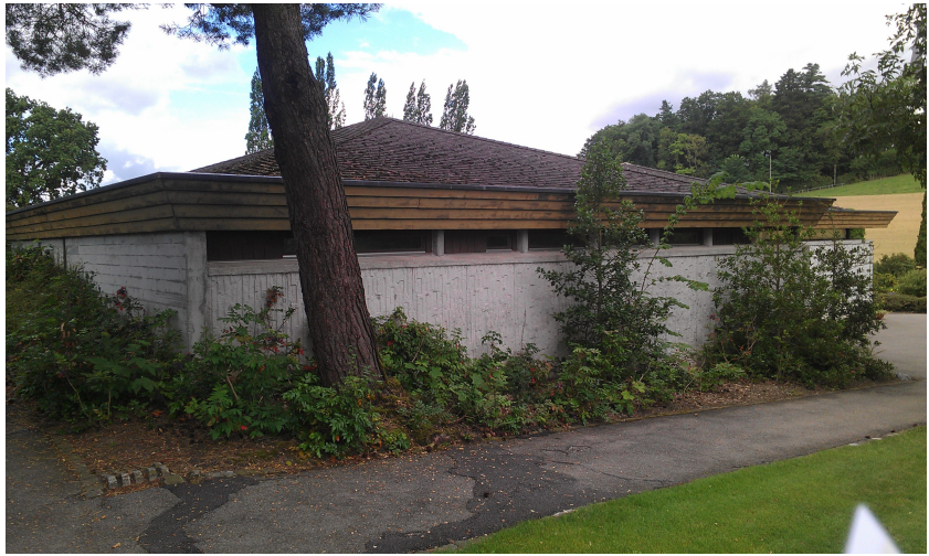
Der bestehende schiefwüchsige Baum (Bild) wird gefällt und auf dem Friedhofsgelände ersetzt. Das Wurzelwerk beschädigt das Gebäude und Leitungen.
