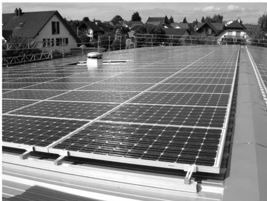
Die Photovoltaikanlage auf dem Werkhofdach ist eine von 32 Anlagen in der Gemeinde.
