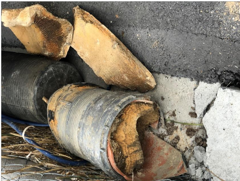
Kanalisation Via da Liuns / Mottapitschna: mit Kalktuff gefülltes Rohr
