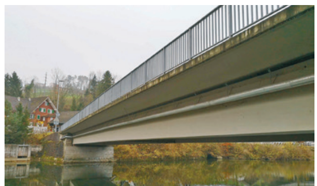
Für die Mühlaubücke ist aufgrund statischer Mängel ein Ersatzneubau vorgesehen.
