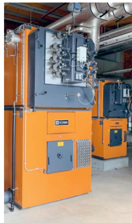
■ Holzheizungsbrenner der Gowak AG Gommiswald.
