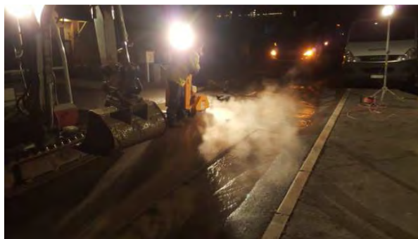
Rupture de canalisation
