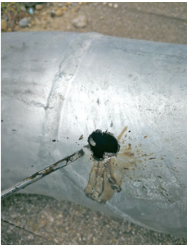
Beispiel eines Leitungsschadens Faulräume
