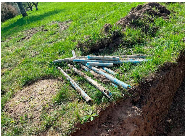
Komplett verkalkte und spröde Brunnenzuleitung
