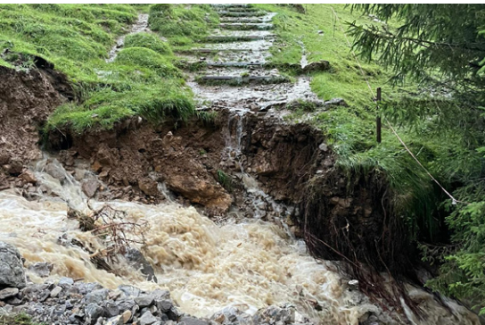
Unwetterschäden am Wanderweg Wasserauen - Hütten - Seelalp
