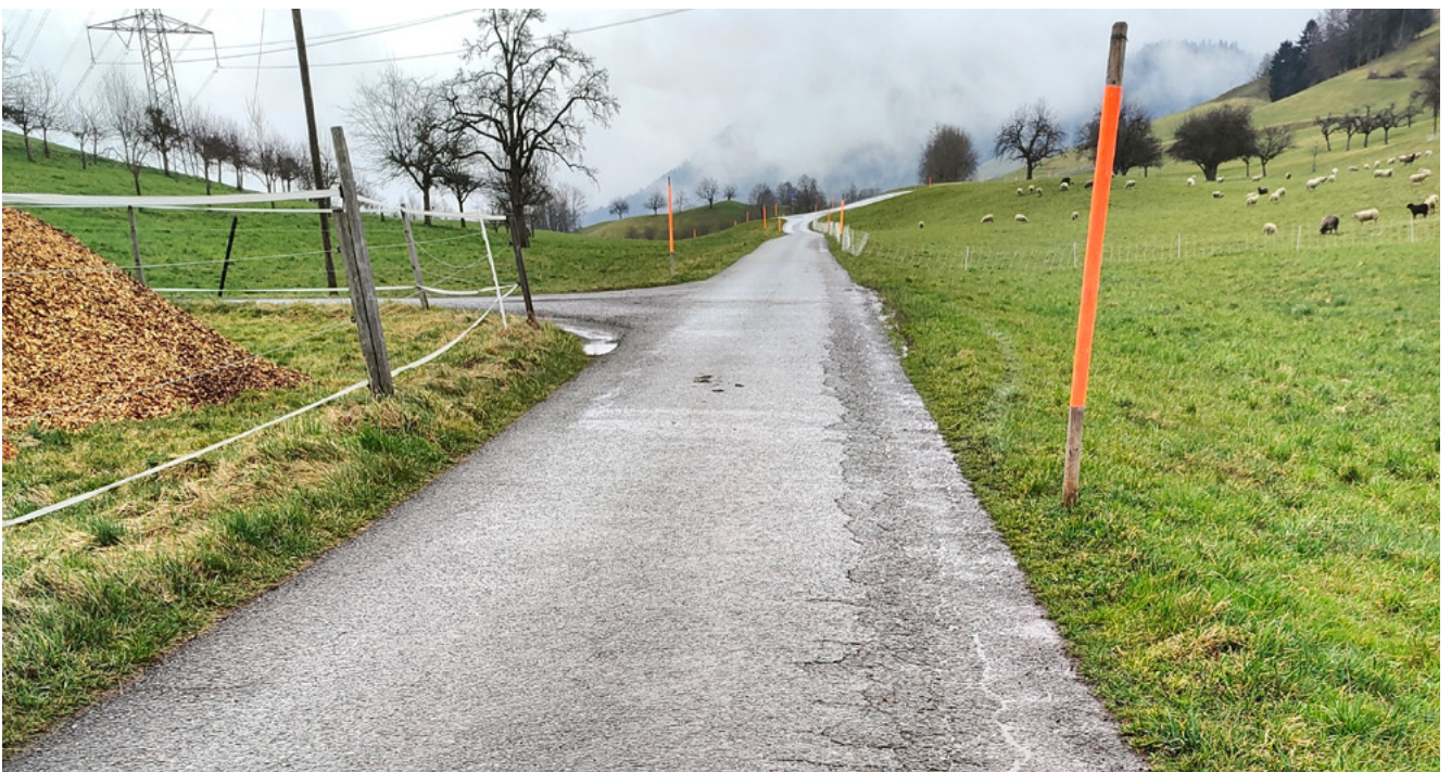
Belagsschäden im Bereich Hinterbrettigen
