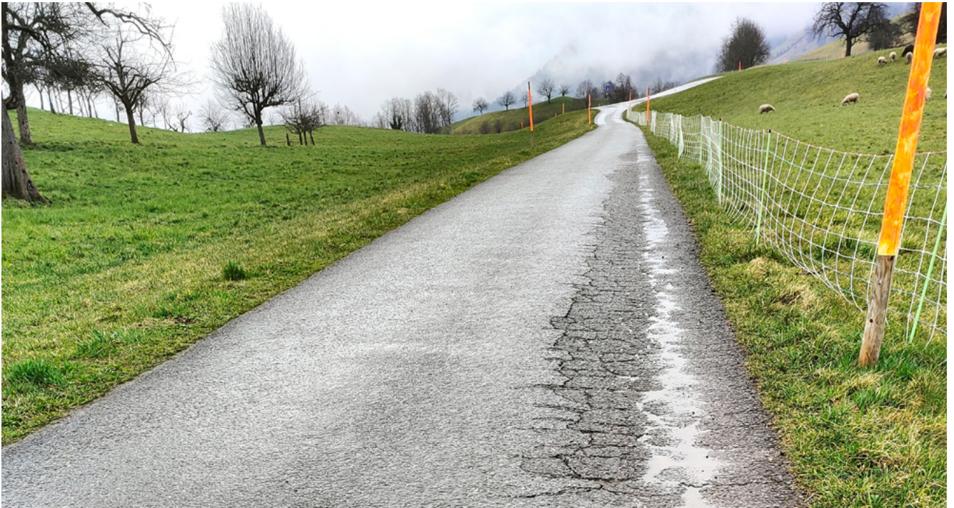
Belagsschäden im Bereich Harget
