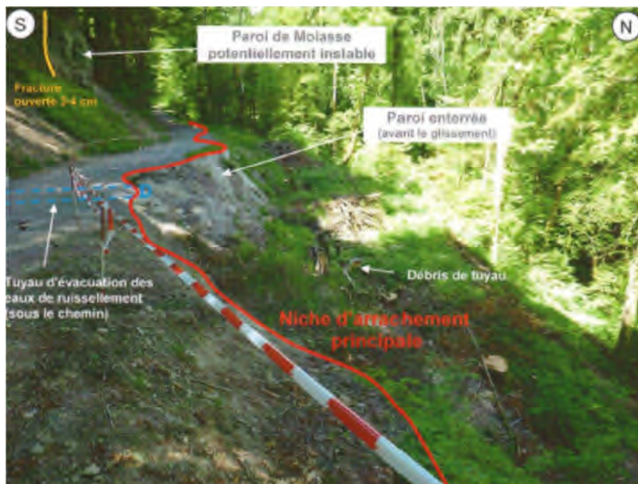
Glissement de mai 2015. Prise de vue en direction de l'ouest.
