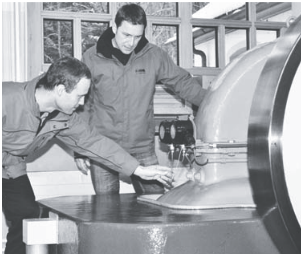
Jürg Göldi und Niklaus Müller von der Wasser- und Stromversorgung bei einer Turbine im Kraftwerk Tobeläckerli.
