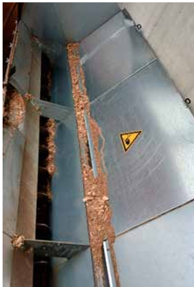
DC Déversoir de plaquettes
