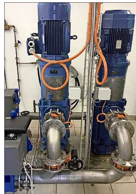
Abbildung 1: Pumpwerk Kirche mit zwei Pumpen.
