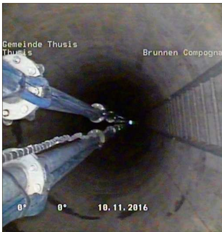
Abbildung 2: Brunnen mit Steigleitungen des Grundwasserpumpwerkes Compogna.
