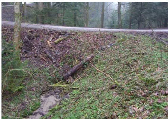
Abb. 1: Durchlass bei Kote 525: Verstopft mit Holz
