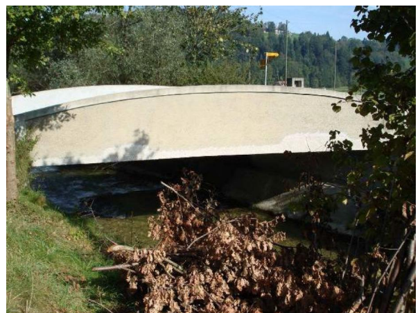
Foto 3 Verklausungsanfällige Brücke mit ungenügender Abflusskapazität in Niderwil (Schwachstelle L4)
