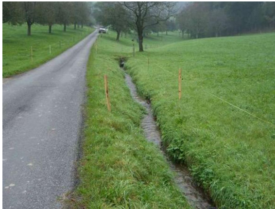
Abb. 1: Gerinne und Durchlass mit ungenügender Kapazität bei Kote 508
