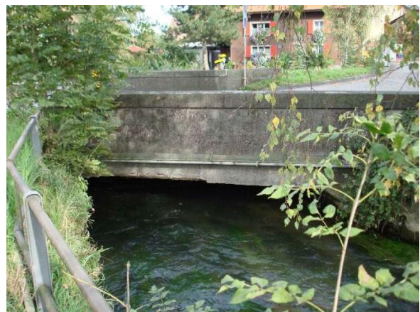
Foto 1 Durchlass Kantonsstrasse, Alberswil (Schwachstelle M2)
