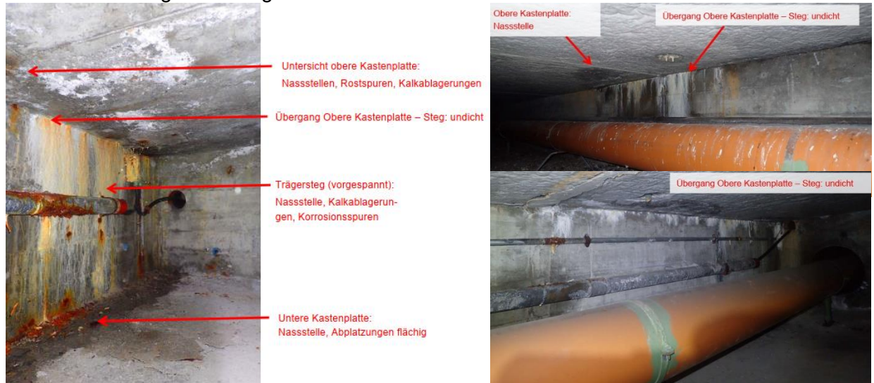
Abbildung 5: UEF AS Buchs – schadhafte Trägerstege und Kastenplatten
