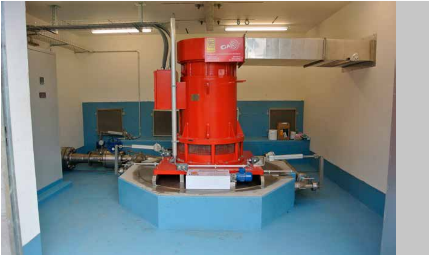
Centrale de turbinage
