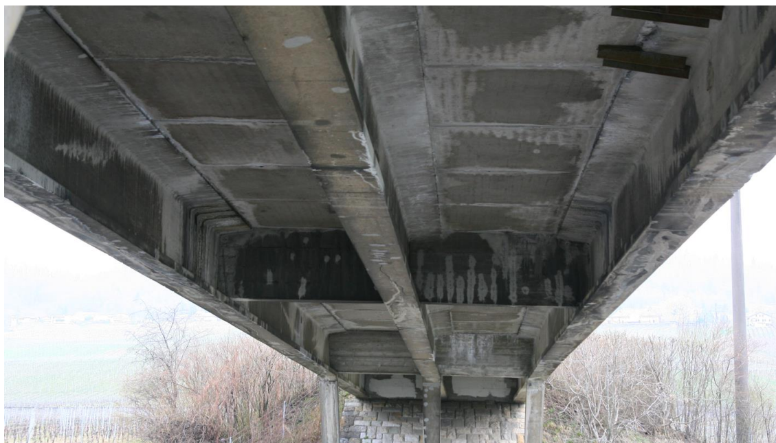
Figure 3: Vue des infiltrations d'eau sous le tablier du pont existant (Surveillance de l'ouvrage du 27 octobre 2022)
