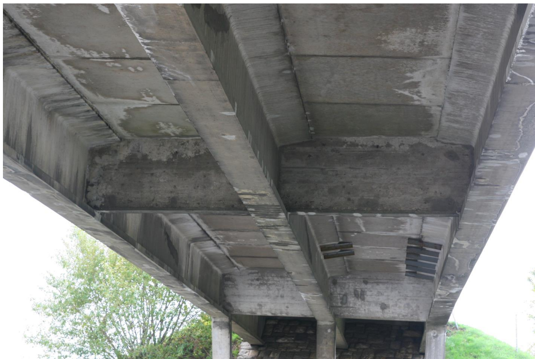
Figure 30: Vue des infiltrations d'eau sous le tablier du pont existant (Surveillance de l'ouvrage du 27 octobre 2022)
