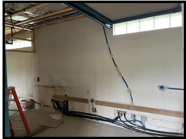
Küchenbereich mit Leitungsinstallationen
