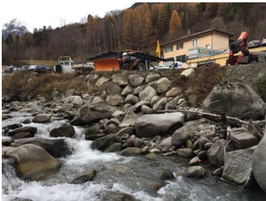
Image 5-16 Enrochements en rive gauche déstabilisés
