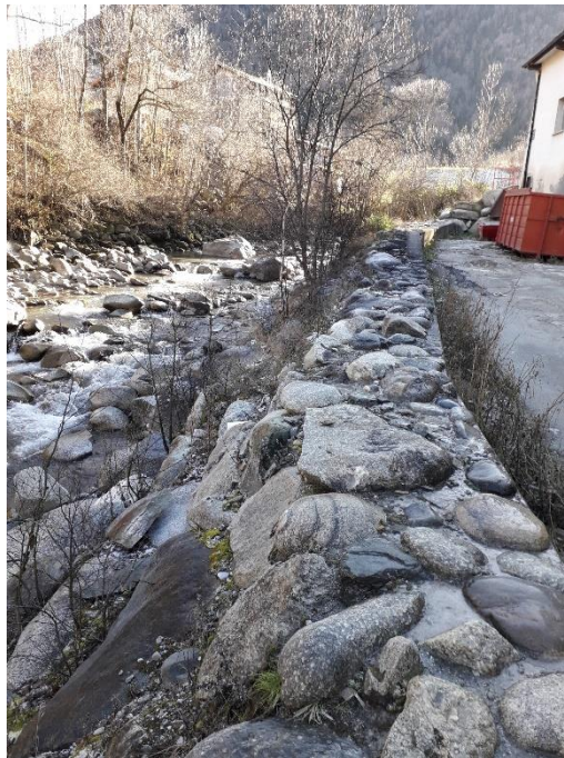
Image 5-3 Muret de protection du sommet de berge en rive gauche à réhausser
