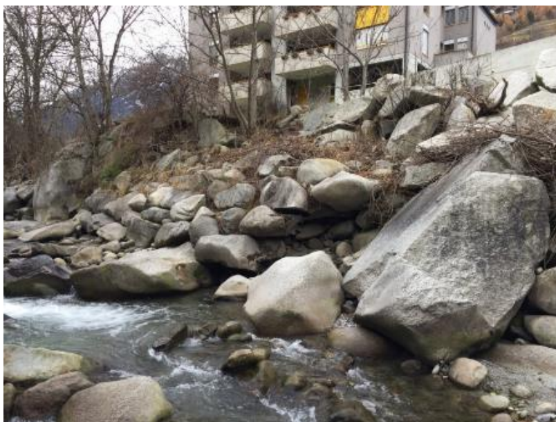
Image 5-15 Secteur courbure en rive gauche PK 6266
