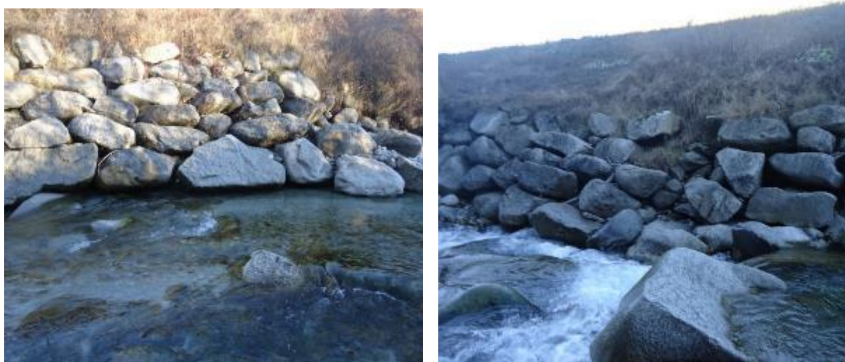
Image 5-1 Incision en pied de berge (photo de gauche) et effondrement local de la berge (droite)
