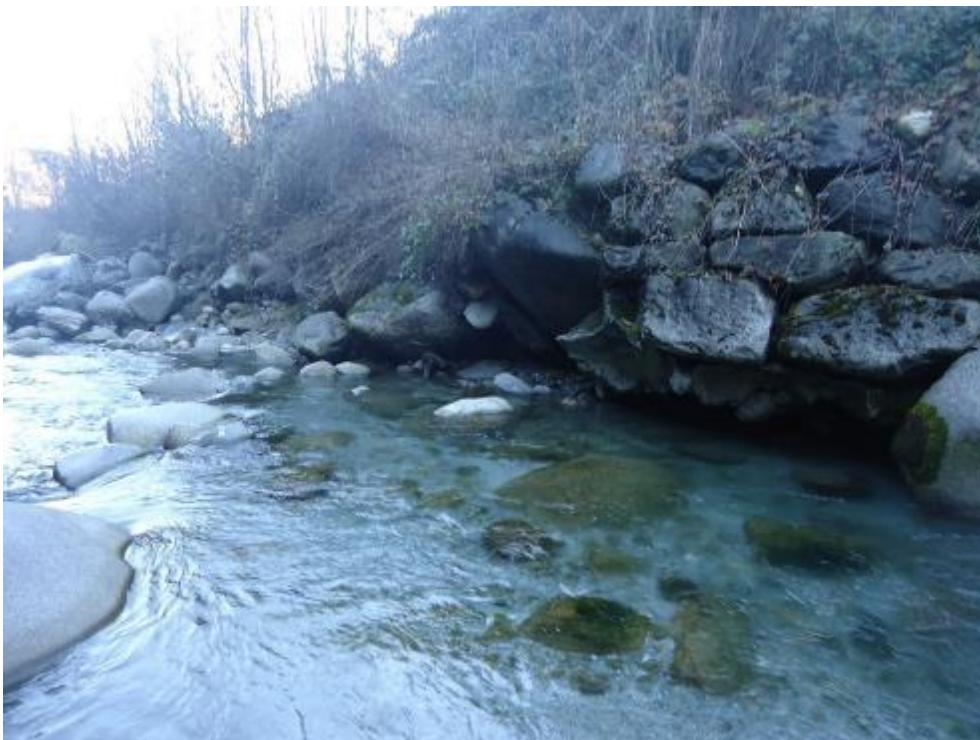
Image 5-2 Arrachement de blocs en pied de berge (source d'instabilisation)
