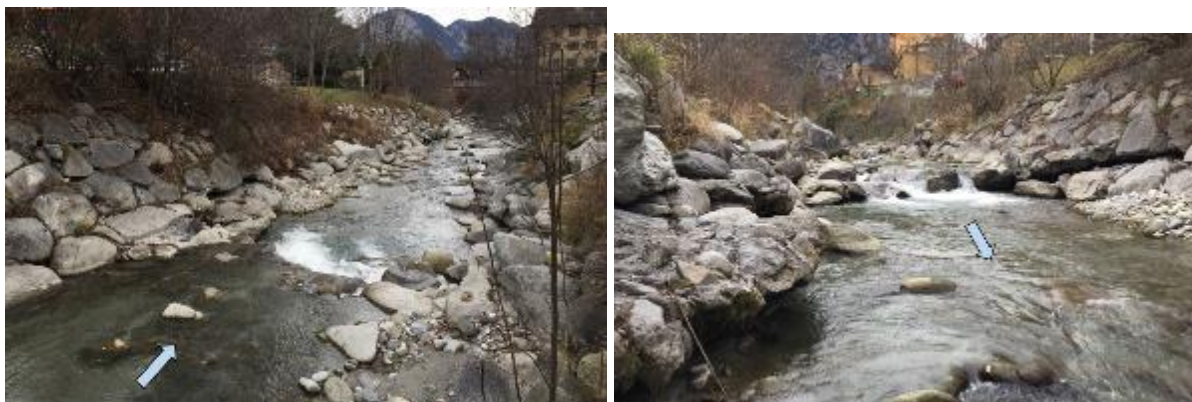
Image 5-12 Etat des seuils au droit des enrochements non bétonnés
