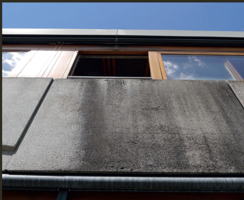
TRACES NOIRES SUR FACADE
