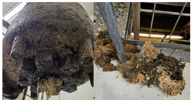
Reissfeste Tücher im Abwasser verstopfen die Pumpen.
