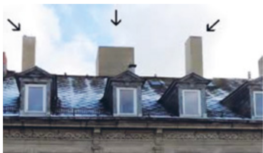
Beispiele von versteckten und optisch getarnten Mobilfunkantennen.
