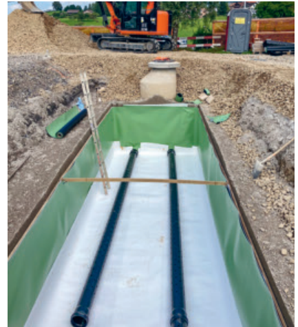
■ Die Retentionsanlage entlastet bei Regen die Gewässer.
