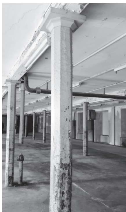
Schadhafte Bausubstanz Spinnerei Uznaberg
