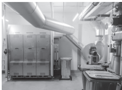
Rauchgasfilter zum Pellet-Heizkessel
