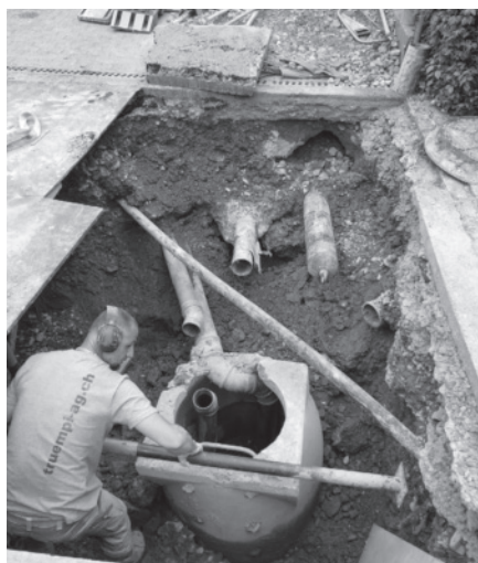
Anschluss der Leer- und Überlaufleitung in der Seeblickstrasse
