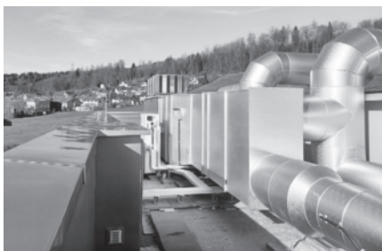
Lüftungsanlage Turnhalle Haslen
