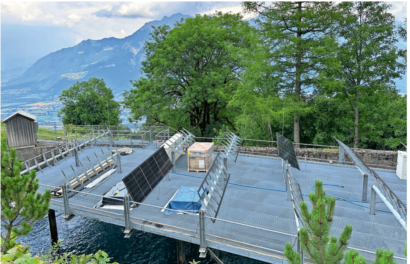
Leistungs- und Effizienzsteigerung: Im November 2025 geht die neue Photovoltaikanlage in Betrieb. Sie benötigt deutlich weniger Module als früher, produziert aber rund 70% mehr Strom als die alte Anlage.
