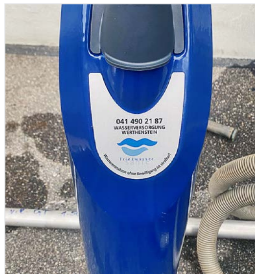
Neues Schild Hydrant
