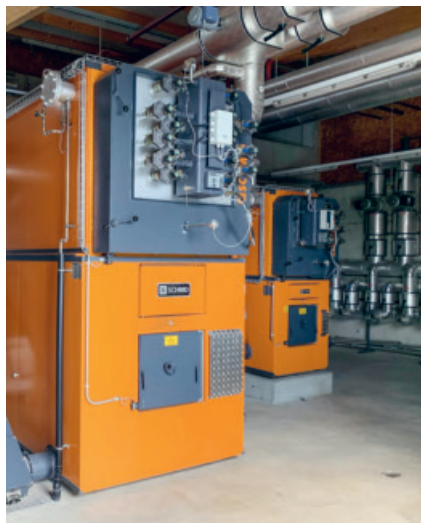
■ Heizbrenner des Fernwärmekraftwerk der gowak in Gommiswald.
