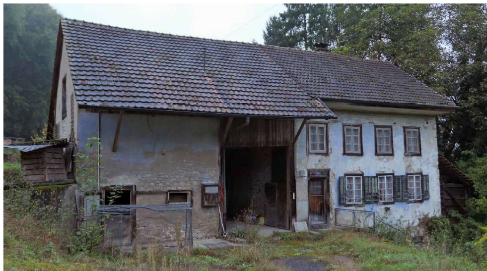
Abbildung 45: Der stark sanierungsbedürftige Mühlehof (SUP907) (Quelle: kantonale Denkmalpflege 2022)
