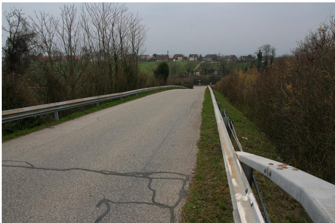
Figure 7: Vue de la route de Bougy, côté Lac (Surveillance de l'ouvrage du 27 octobre 2022)
