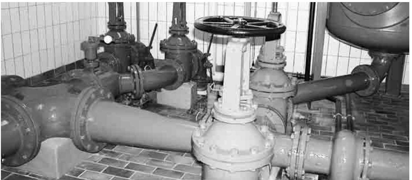
Ein Blick ins Pumpwerk Rheinau.
